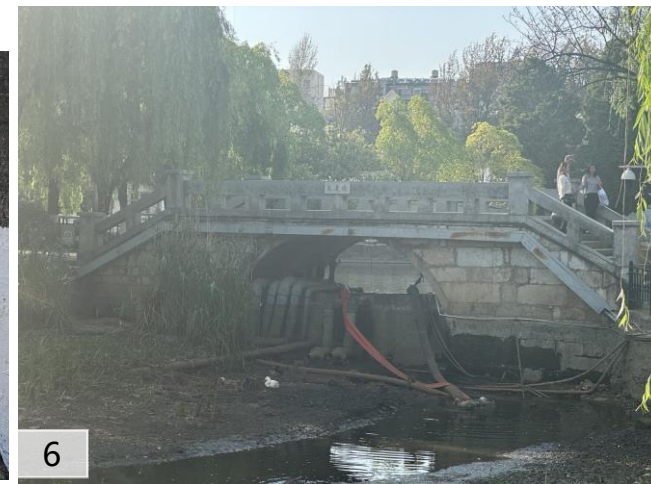
1、6池现状桥涵被封堵，依靠水泵抽
