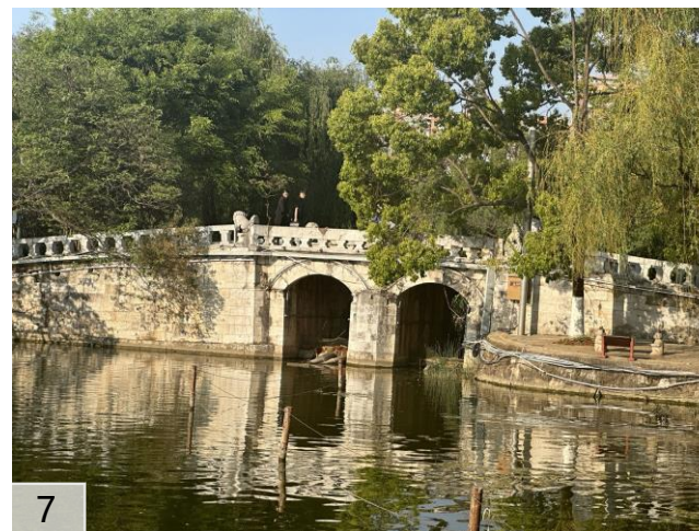
2、6池现状桥涵被封堵，依靠水泵抽
