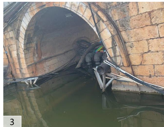
4、5池现状桥涵被封堵，依靠水泵抽排
