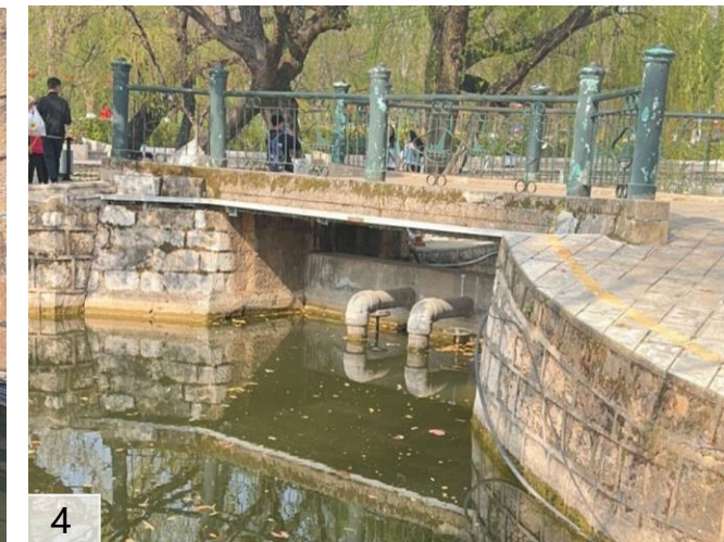
5、9和6、7池桥涵被封堵，依靠水泵抽排
